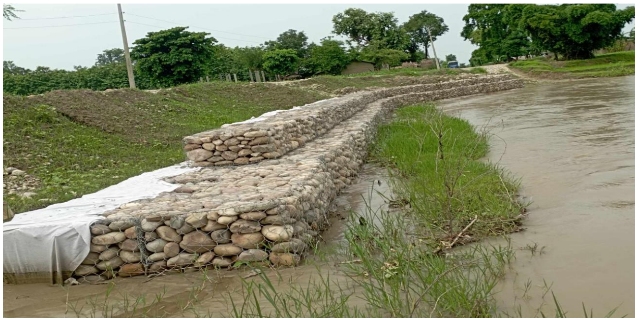
गेरुवा गा पा वडा न ६ लाहोरपुर मैला नाला मा निर्माण गरिएको तटबन्द
